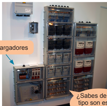
Figura A.64. Descargadores de sobretensión en una centralización de contadores.
